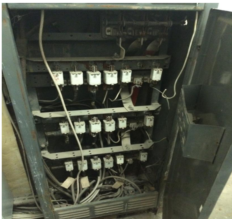
Рисунок 10. Учебное здание №7, ВРУ-2, СЩ №1 (состояние удовлетворительное)
