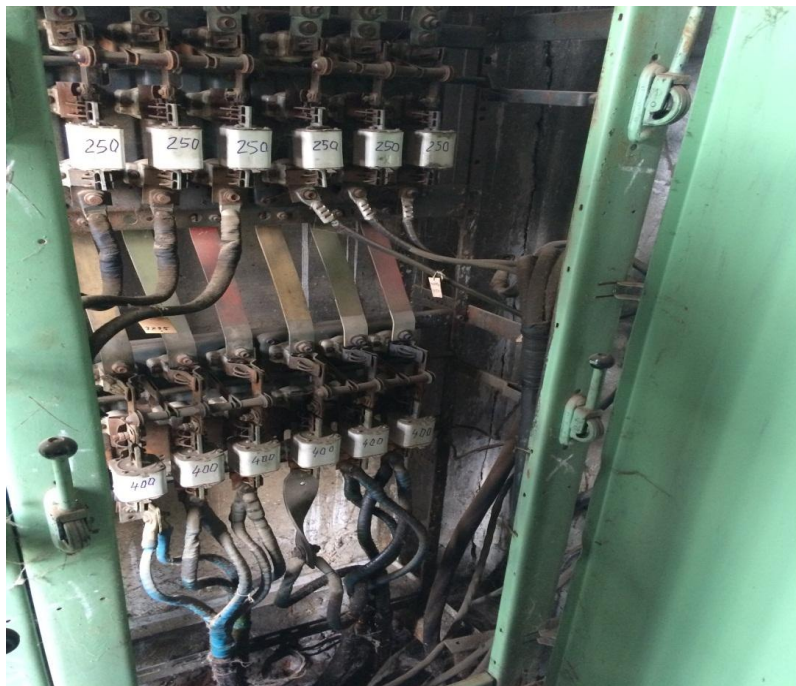
Рисунок 7. ТП-396, отходящая линия яч.2 (состояние удовлетворительное)
