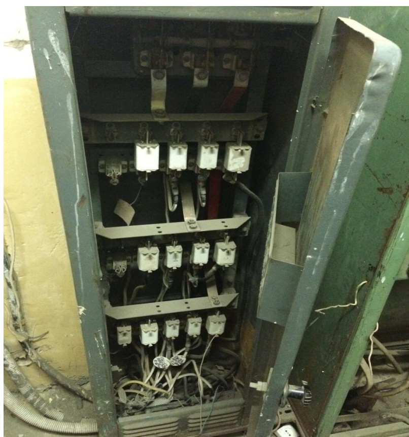
Рисунок 8. Учебное здание №7, ВРУ-2, СЩ №3 (состояние удовлетворительное)
