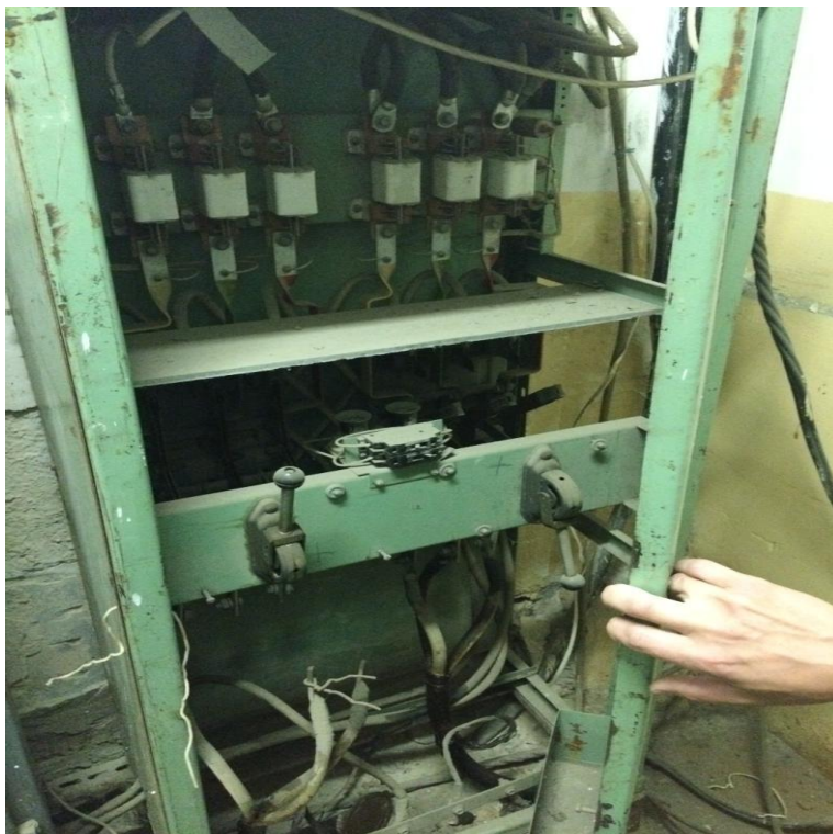
Рисунок 9. Учебное здание №7, ВРУ-2, СЩ №2 (не исправен резервный кабель)
