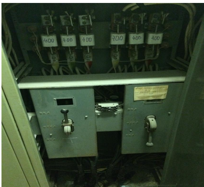
Рисунок 14. Учебное здание №7, ВРУ-1, Ввод 2 (состояние удовлетворительное)
