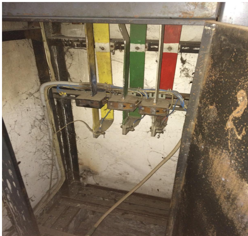
Рисунок 1. ТП-396, Ввод 1 (состояние удовлетворительное)
